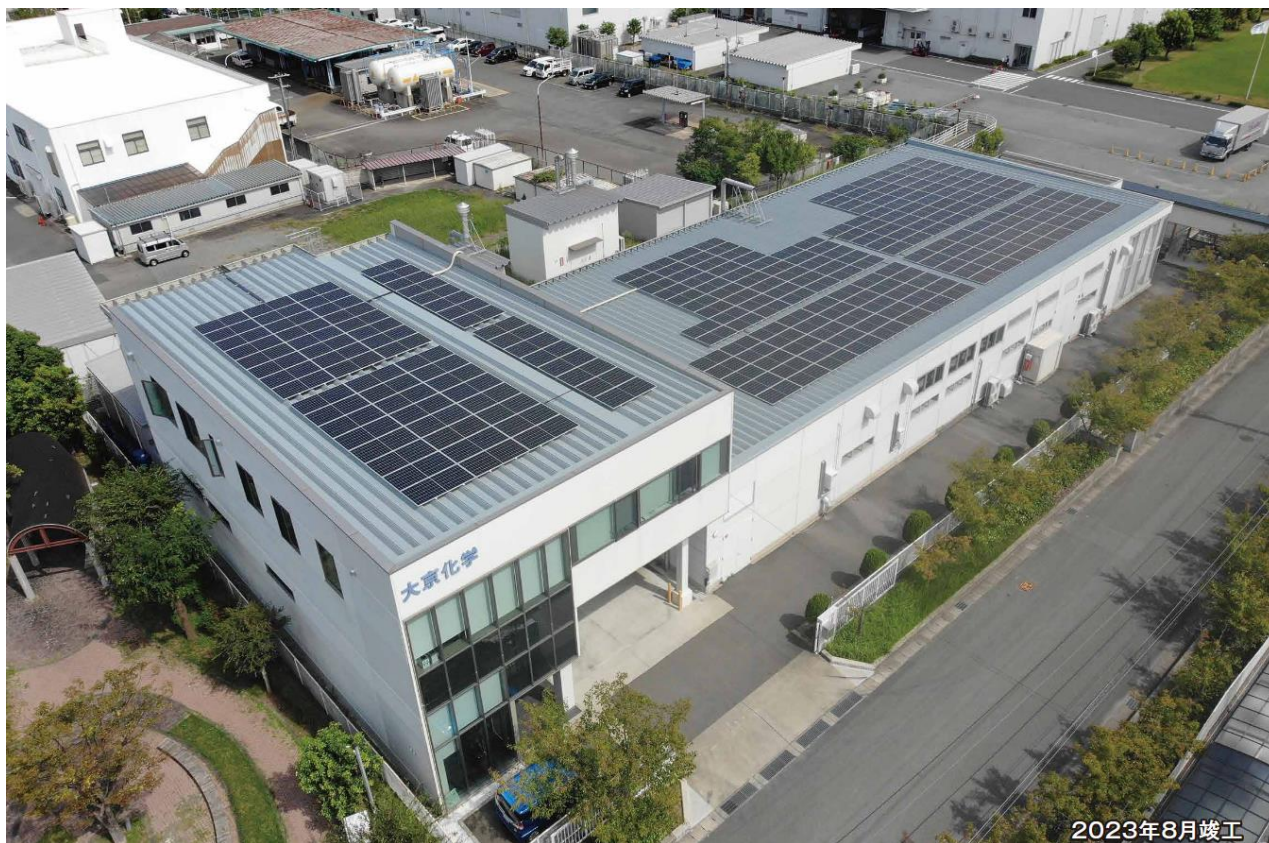
▲大京化学株式会社 本社・工場屋根に設置された太陽光発電設備（2023年8月竣工）
